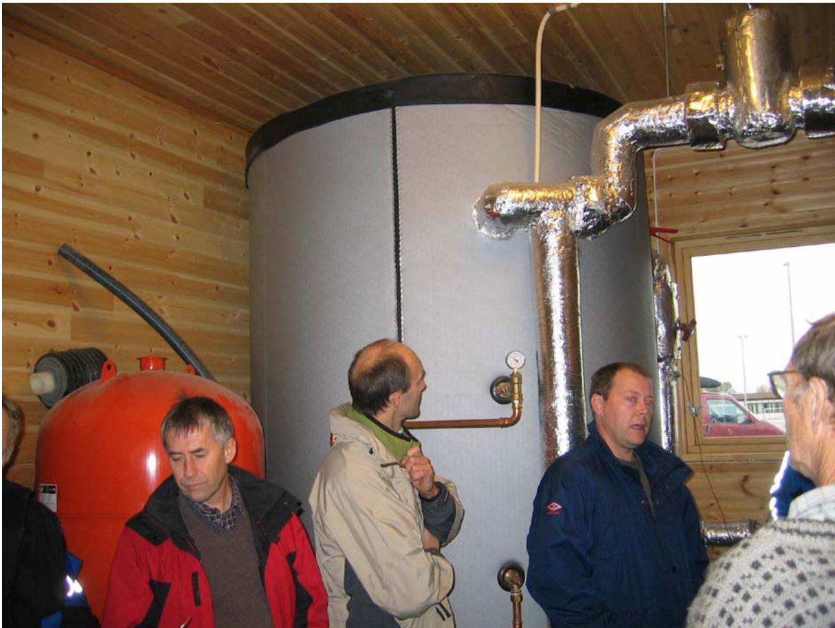
Bilete er frå synfaring til biobrenselanlegg i Sveio
