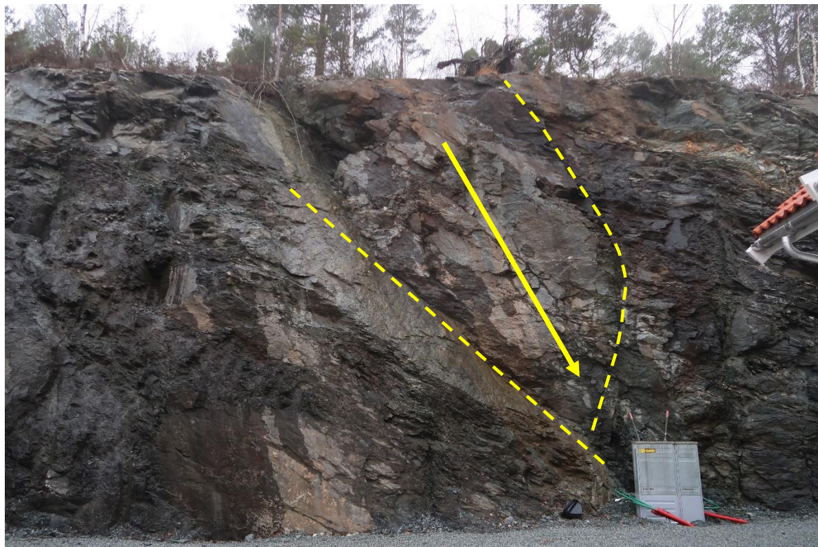
Figur 3. Eksempel på skjæring med avløste bergpartier og -blokker. Gule striper og pil markerer en mulig kileutglidning. Skjæringen utgjør en fare for personer, kjøretøy og for flere av eksisterende bygg.
