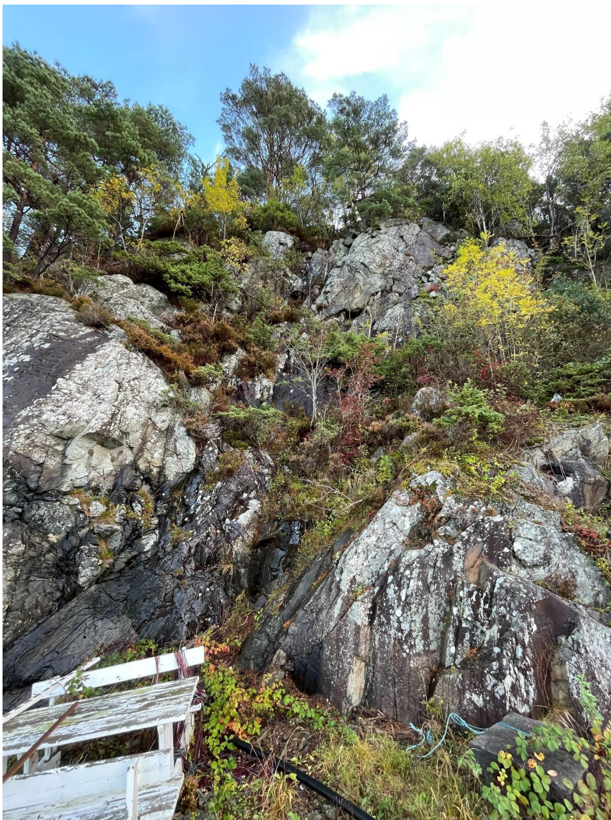
Figur 11: Skrent helt vest i kartleggingsområdet. Oppsprukket berg og delvis avløste blokker med fallretning direkte ned mot benken gjør at vi vurderer årlig løsn sannsynlighet som større enn 1/100.
