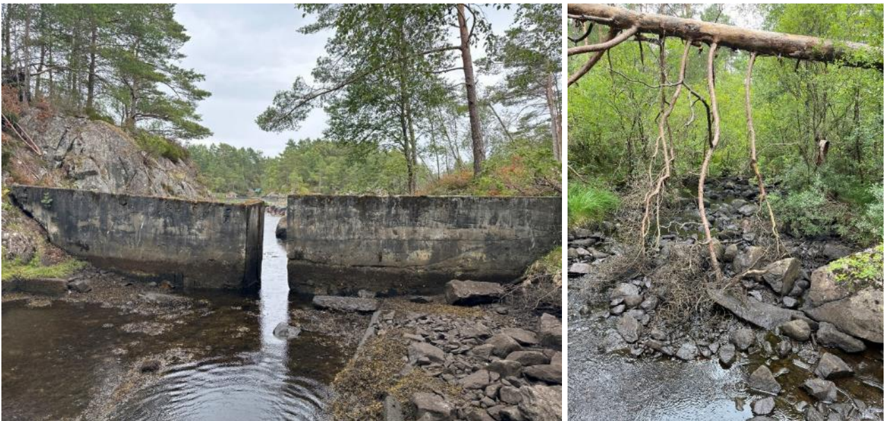
Figur 4-49. T.v. Rester av demning eller betongtank ved utløp til sjøen som ble brukt til oppdrett av regnbueørret tidligere. Nedre del av Stokkabekken opp fra sjøen t.h, like innenfor restene av demning/tank.
