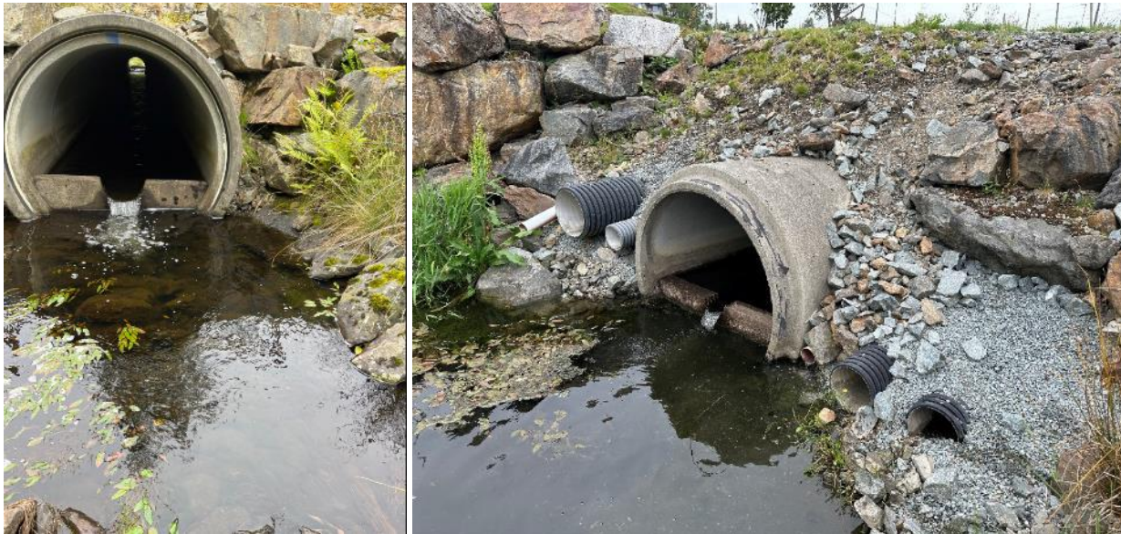
Figur 4-56 Kulverter tilrettelagt for fiskevandring under fv. 542. Fra Kverntjønna til Åsvatnet t.v. og fra Åsvatnet til Stokkavatnet t.h.
