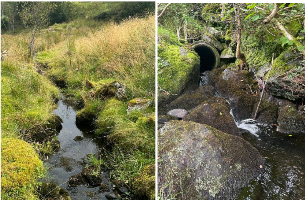
Figur 4-11. El-fiskestasjon i nedre del av bekken og kulvert under Tjongsvegen som stort sett er et vandringshinder for sjørret.
