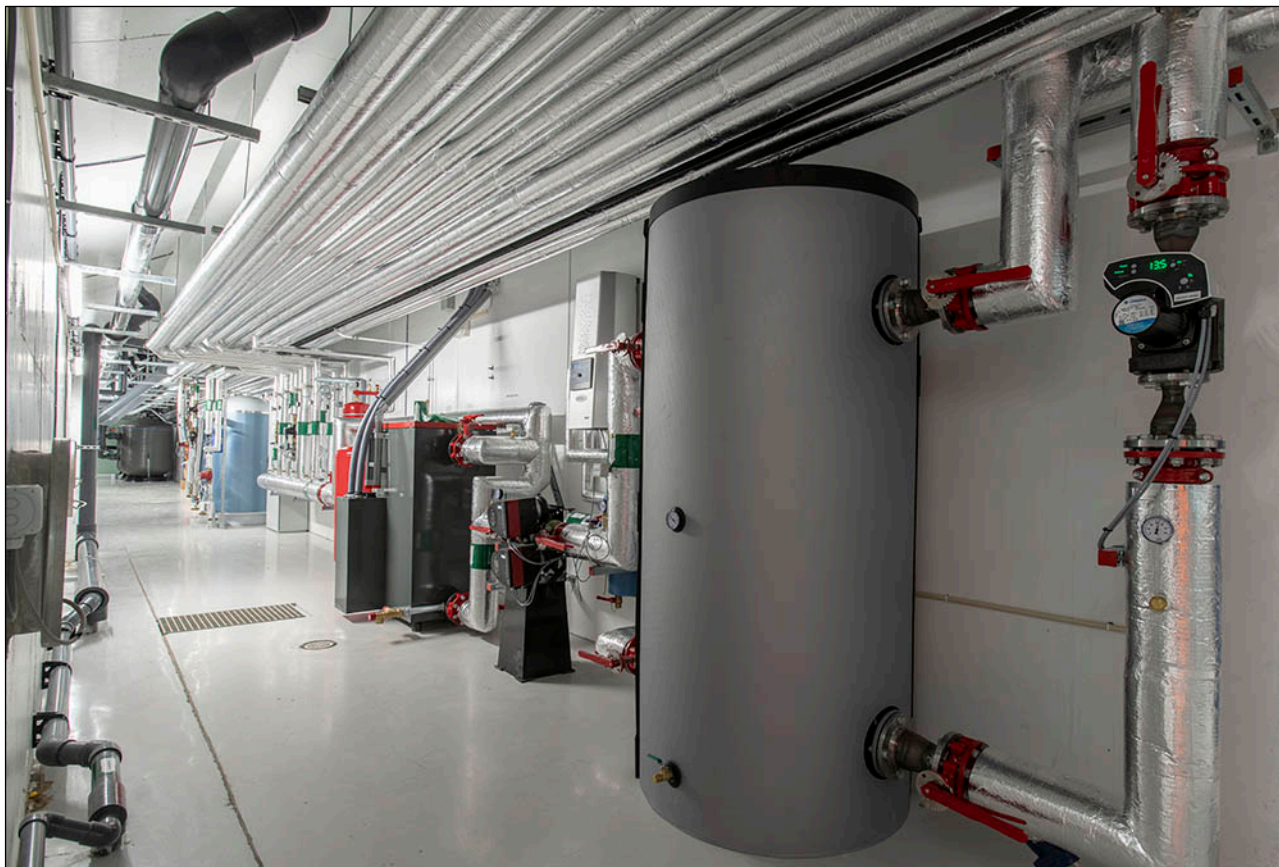
Bømlo symjehall vart sett i drift i 2018 og krev mykje teknisk utstyr.
